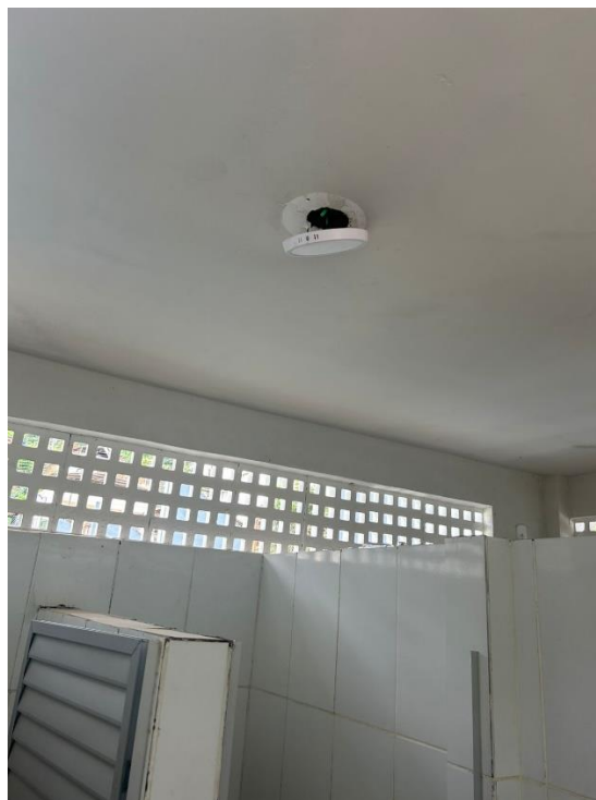
Figura 7 – Luminária executada divergente do projeto e danificada. Fonte: elaboração própria
