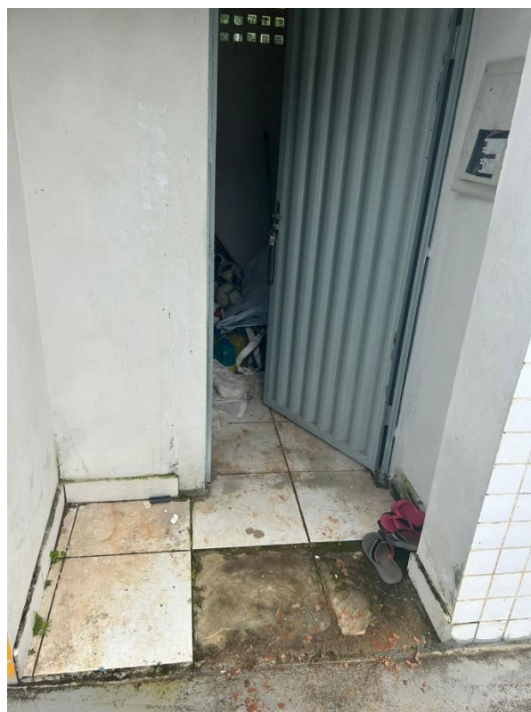
Figura 10 – Revestimento quebrado acesso depósito e QDC geral - Fonte: elaboração própria.
